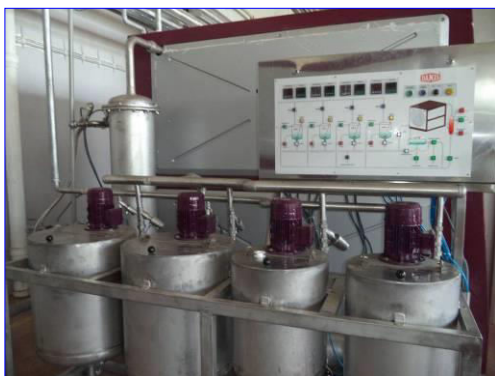
Слика 9 Контролен панел
