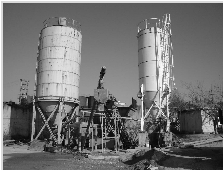
Слика 2 Бетоњера и силуси за складирање на цемент
