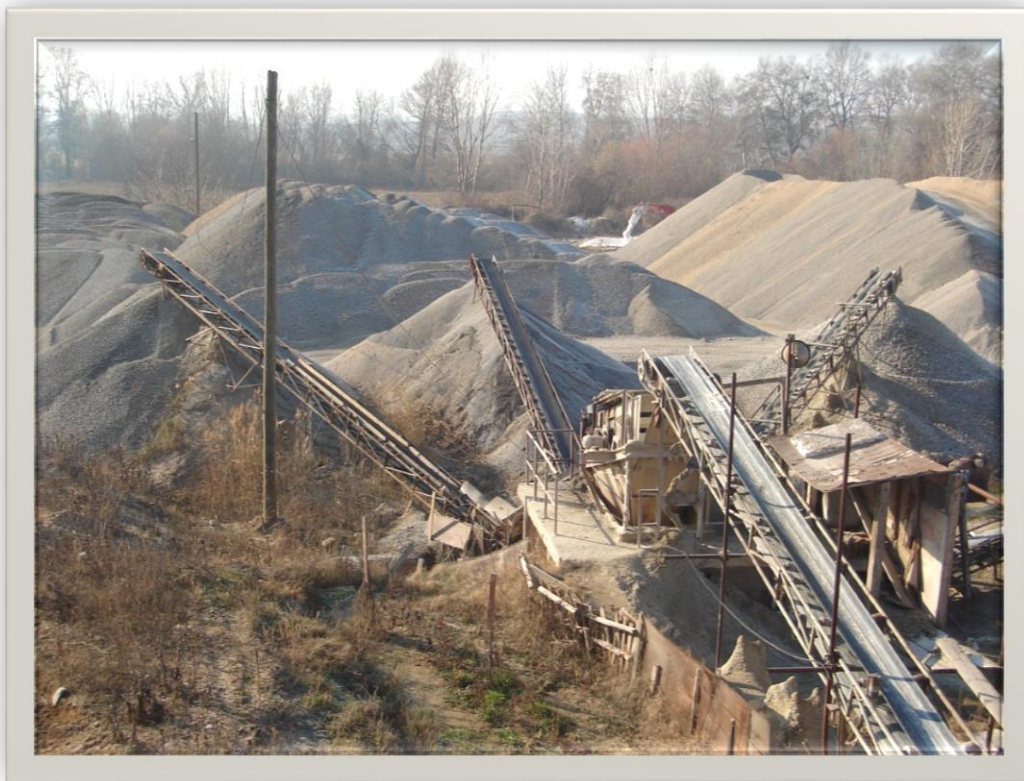
Инсталација: Сепарација за песок и бетонска база АД Бетон -Штип
