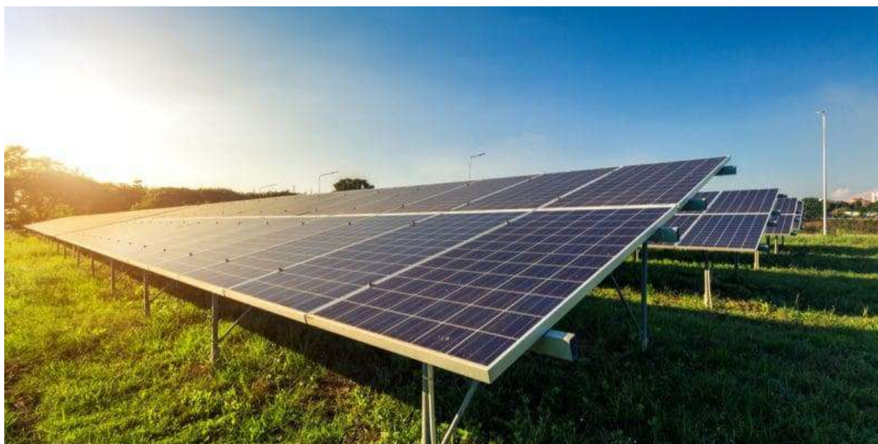
Слика 2. Изглед на фотонапонска централа на градежно земјиште
