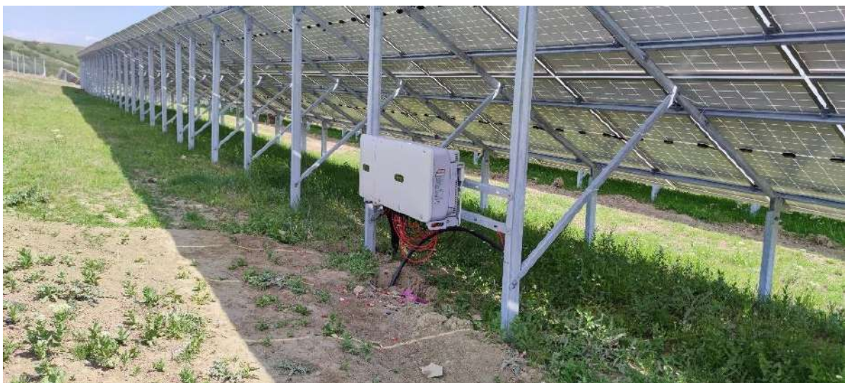
Поцинкувана кострукција и монтирани панели со Инвертор на фотонапонската централа
