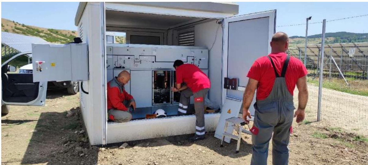
Компактна бетонска трафостаница КБТС 20(10)/0.4 kV ; 1250 kVA
