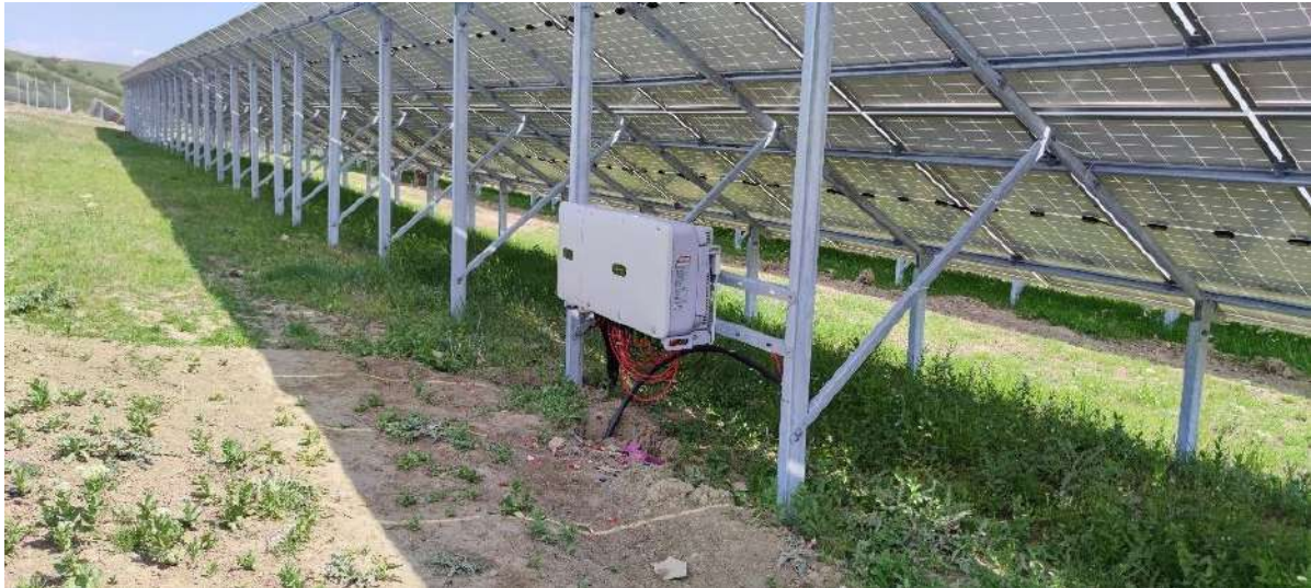
Поцинкувана конструкција и монтирани панели со Инвертор на фотонапонската централа
