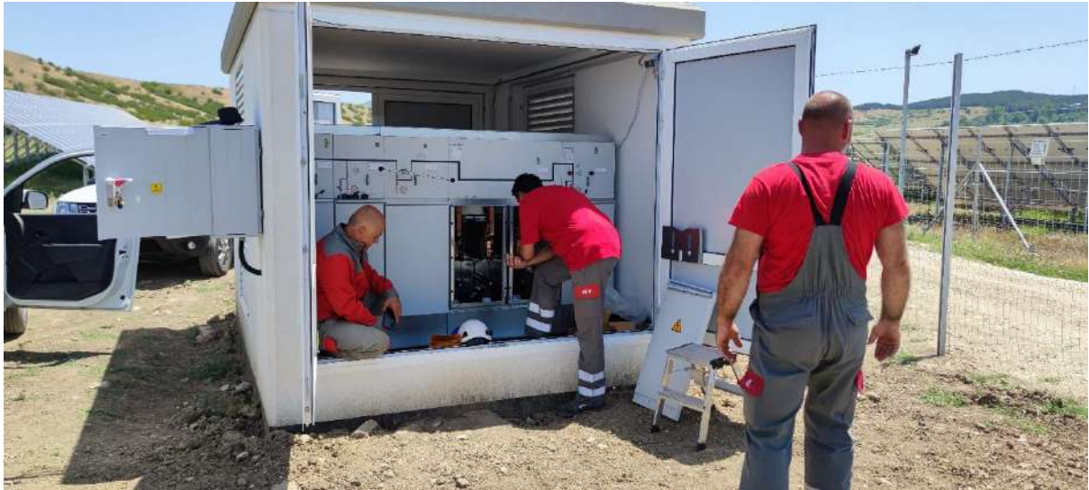
Компактна бетонска трафостаница КБТС 20(10)/0.4 kV ; 1250 kVA
